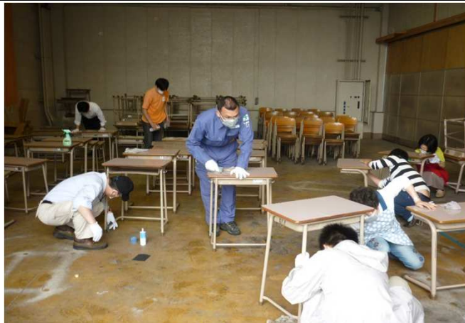
机・椅子補修 「錆落としのヤスリがけ」
